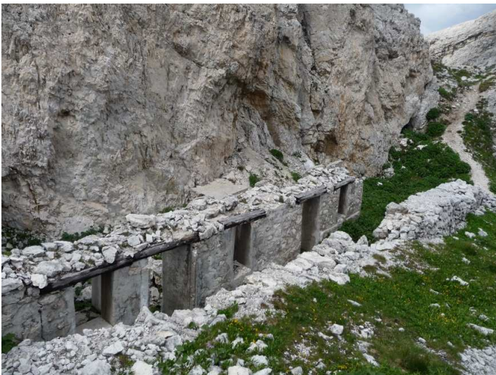
Fig. 1 Edificio diroccato localizzato in prossimità del Rifugio Col Gallina - Cortina d'Ampezzo, testimonianza dei ricoveri utilizzati dai soldati. Sono visibili i resti del manufatto di protezione dalle schegge delle bombe.
