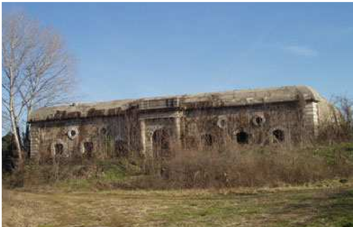
Vista frontale della batteria
