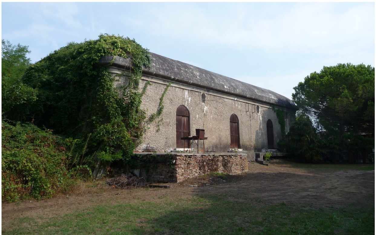
Vista posteriore della batteria
